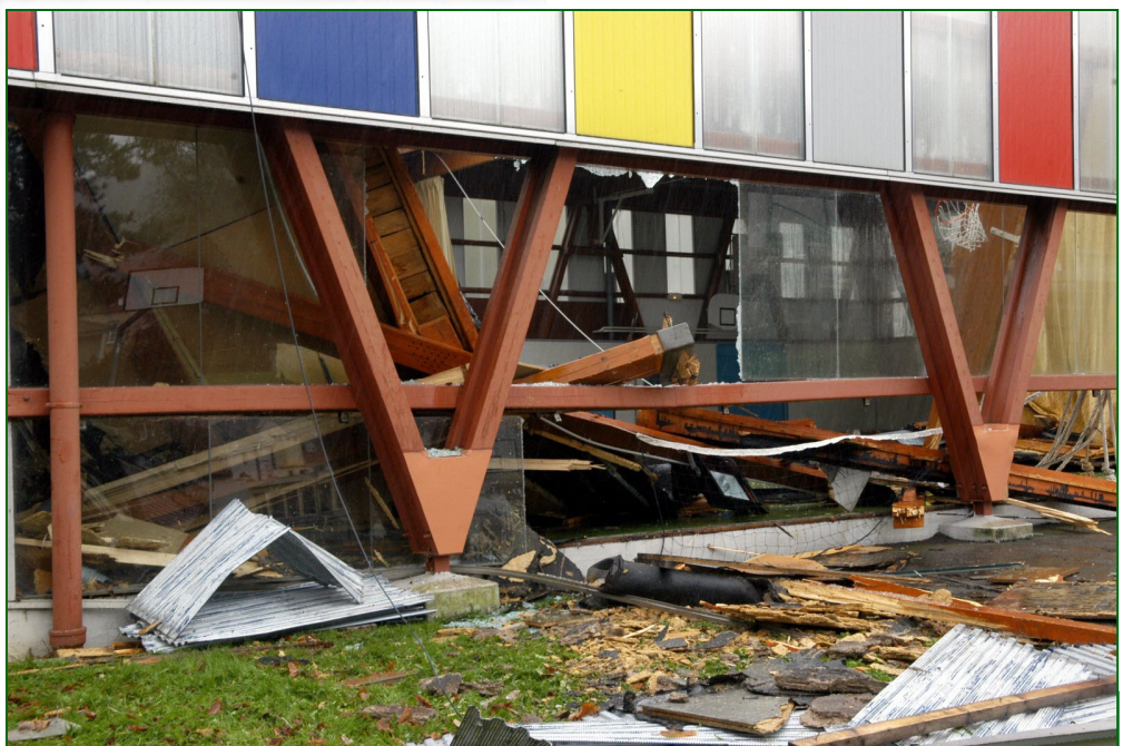
Effondrement de la toiture d'un gymnase
